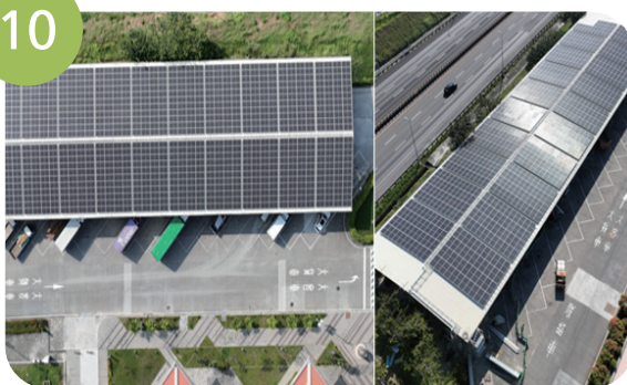
高公局關廟服務區 台南 713.4 kWp
