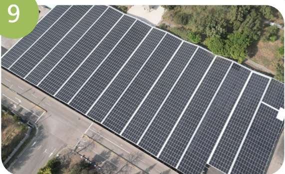
梧棲漁港停車場一期 台中 1,987.2 kWp
