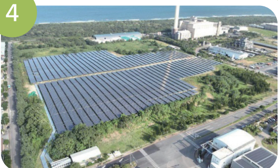
五結掩埋場 宜蘭 8,541.115 kWp
