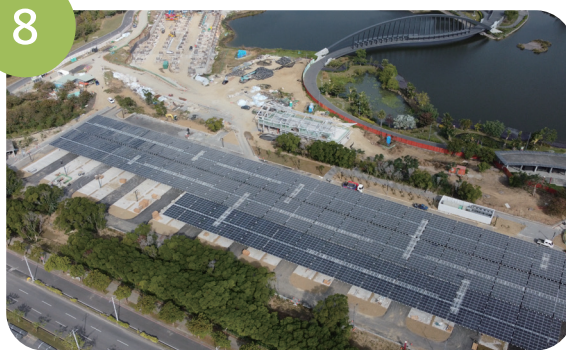
故宮南院 嘉義 1,300.11 kWp
